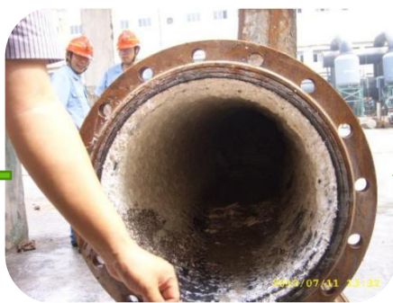
磁化管下游管壁结垢脱落 露出了黑色管壁
